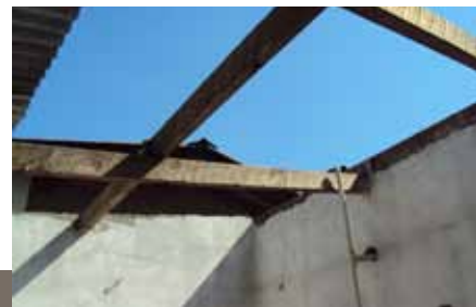
Une partie du toit du bâtiment s'est « envolée » lors de l'ouragan Sandy en automne 2012. Un budget de reconstruction est à l'étude
